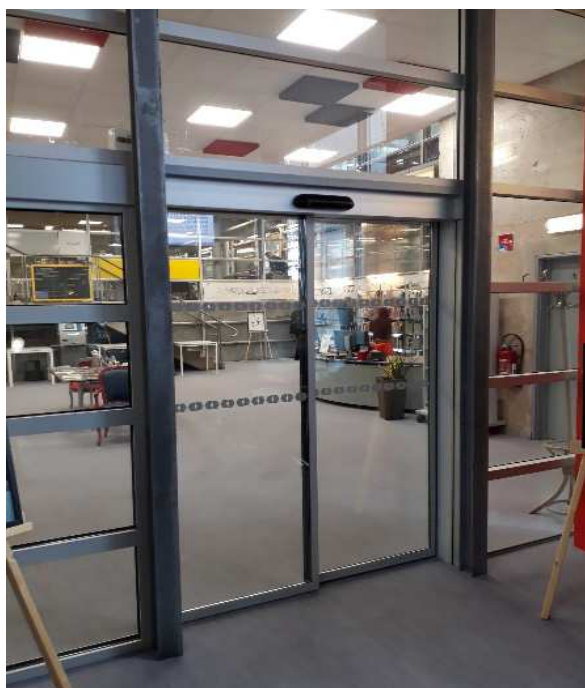
Ouverture porte automatique
