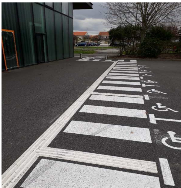
Signalisation parking – marquage au sol
