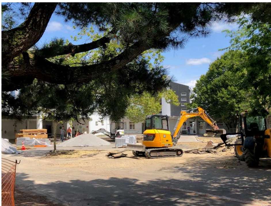
La cour de l'école Pauline Roland élémentaire en cours de débitumage, pour accueillir une nouvelle cour nature, égalitaire et inclusive.
